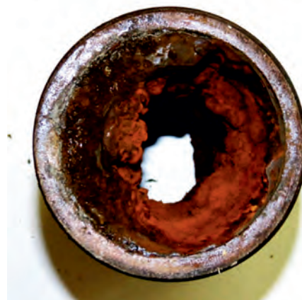
▲ Takovéto potrubí ovlivní nejen čistotu vody, ale i tlak
